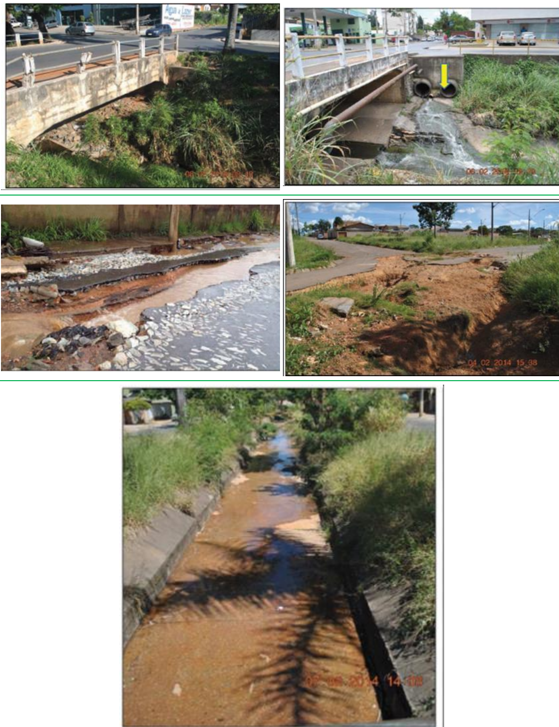
Figura 3.16 – Situações sobre drenagem urbana em Sete Lagoas.
